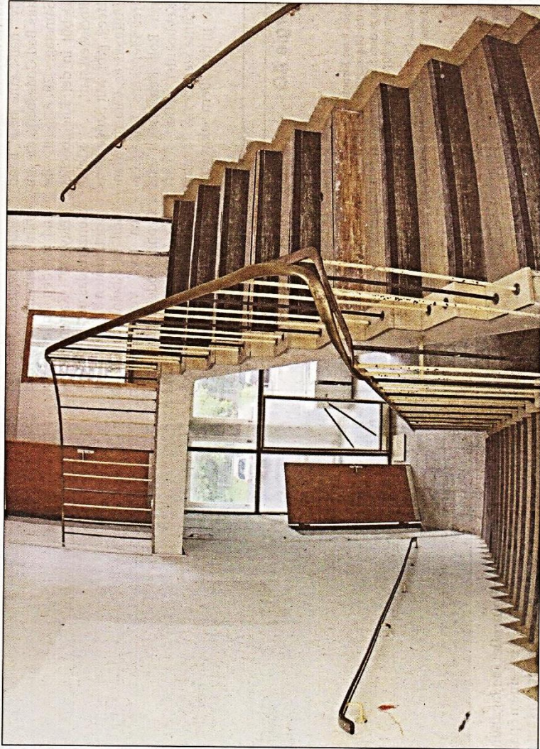
Einblick: Das Treppengeländer ist wacklig, die Stufen sind unvollständig. Seit der Aufgabe als Übergangsheim für Asylanten 1996 steht das Gebäude leer.
