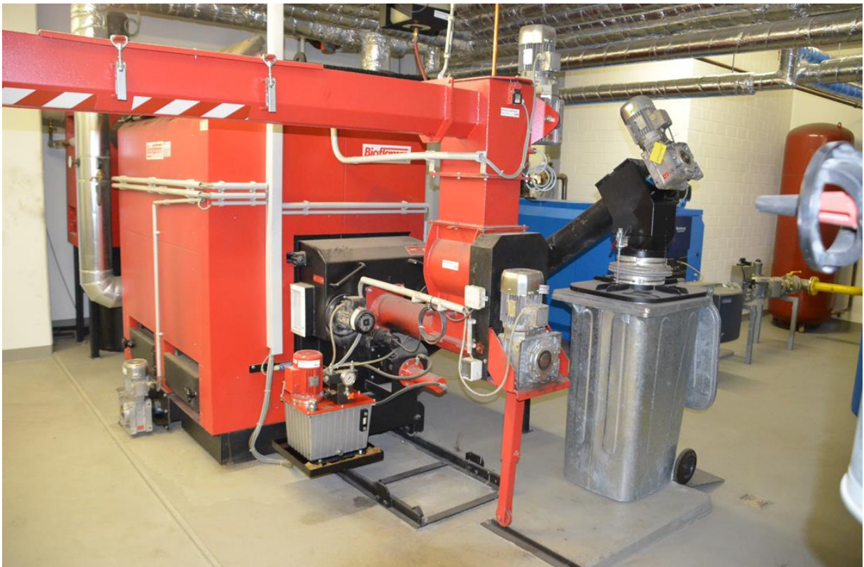
Schulzentrum Walbach, Pelletkessel
