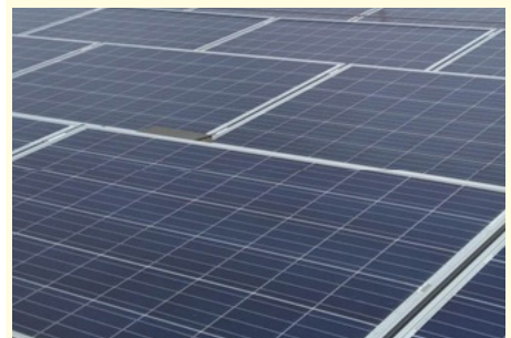
Photovoltaikmodule auf dem Dach des Schulzentrums
