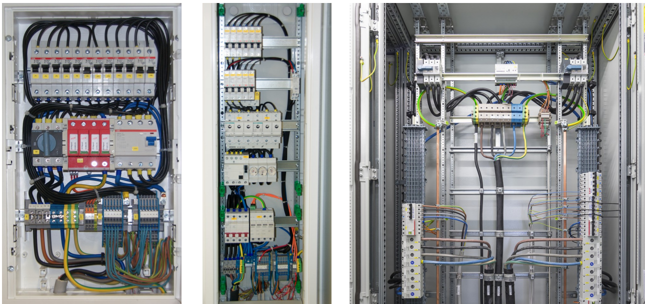
Bild 4-1: Elektro-Verteilungen, links und Mitte nicht skalierbar, rechts 2 skalierbar
