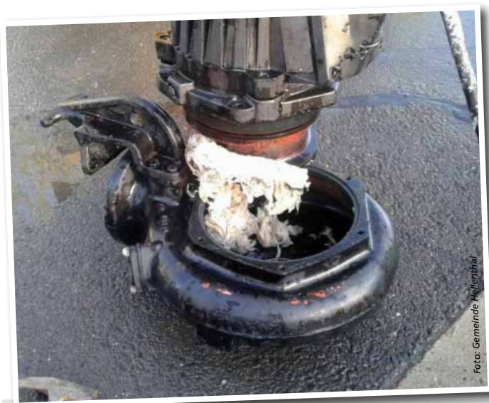
Verstopfte Abwasserpumpen bereiten immer wieder Probleme.
