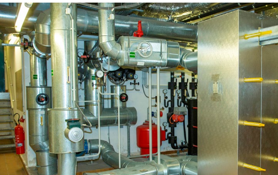
Wärmetauscher der Heizung am Standort Hamburg
