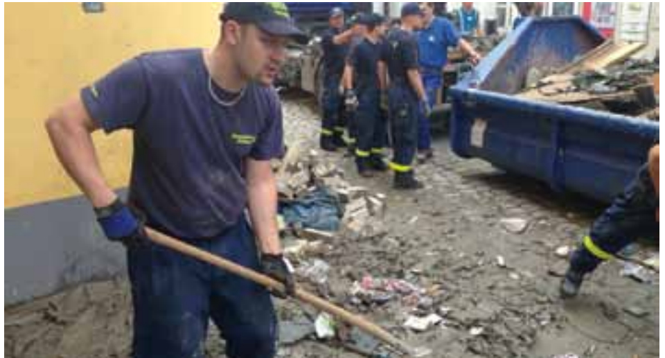
Das Wasser ist abgelaufen – übrig bleiben Unrat und Schlamm.
