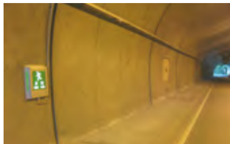
Beleuchtete Hinweise weisen den kürzesten Weg aus dem Tunnel.
