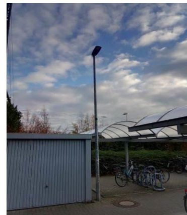
Modernisierung Beleuchtung AXIA LED III
