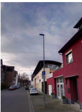
Modernisierung Beleuchtung AXIA LED
