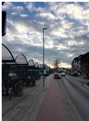
Modernisierung Beleuchtung AXIA LED II
