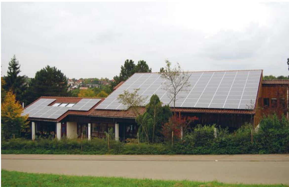
Photovoltaik-Anlage auf dem Kindergarten in Oberweissach
