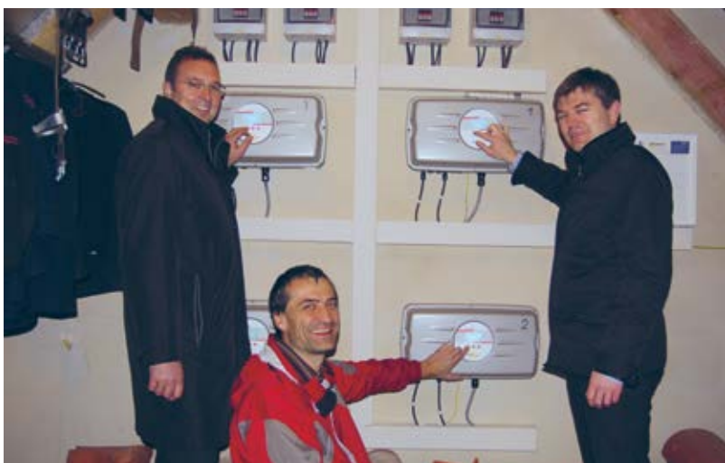
Von oben: Kommunale Dachflächen für alle nutzbar machen (Standort Bildungszentrum Weissacher Tal), Photovoltaikanlage auf dem Gebäude der Weissacher Feuerwehr, Startschuss für gemeinschaftliche Photovoltaikanlage
