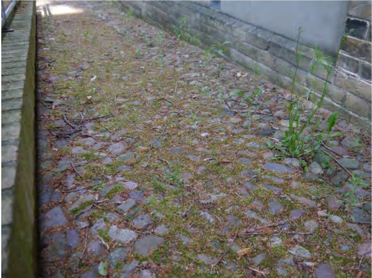
Abb. 25: Folgekosten, wie die Pflege einer Rampe, werden oft nicht ausreichend berücksichtigt
