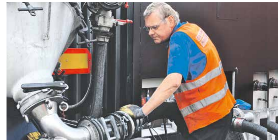
Ein Mitarbeiter bindet den Silo-LKW an das mobile Siloamaxx-System an
