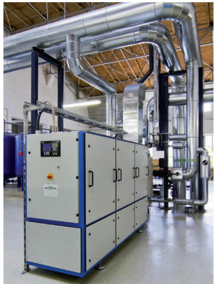
Stromerzeugung durch Blockheizkraftwerk Foto: ©VKU/regentaucher.com
