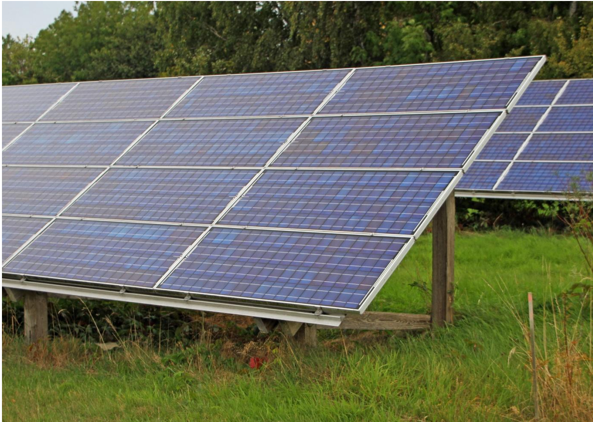
Abb. 19: Photovoltaik-Freiflächenanlage (Foto: J. LIESEN)
