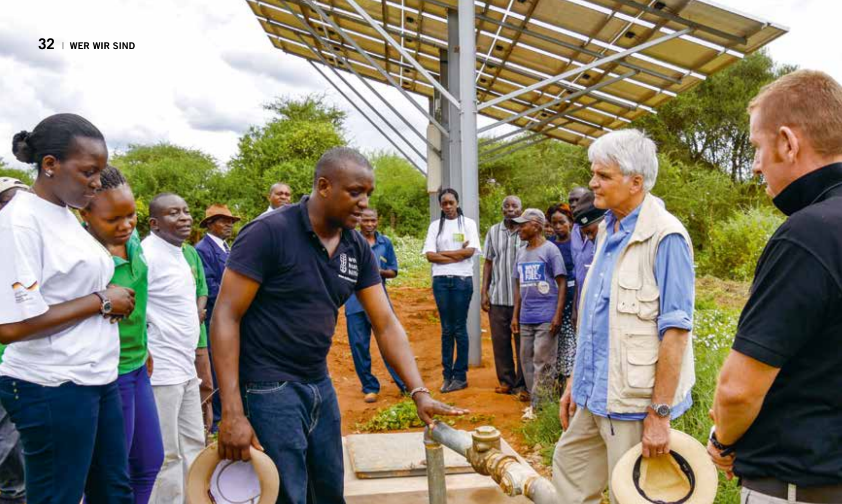
Sauberes Wasser für mehrere Hundert Menschen in Kenia dank solarbetriebener Pumpen. Dr. Albert Otten, promovierter Volkswirt und seit 2007 ehrenamtlicher Geschäftsführer der Stiftung Welthungerhilfe, überzeugt sich vor Ort über den Projektfortschritt.
