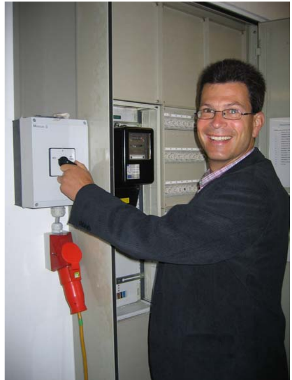
Bürgermeister Alexander Büttner freute sich über die Notstromeinrichtung im zentralen Feuerwehrgerätehaus, die bei entsprechenden Einsätzen die Sicherheit der Bürgerinnen und Bürger unterstützt.
