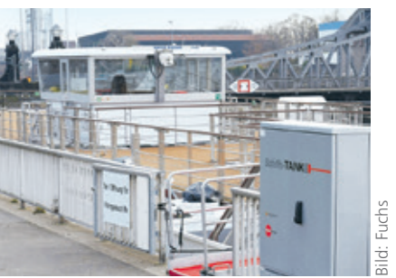
Strom statt Diesel: Hotelschiffe werden über die „SchiffsTankE“ versorgt.
