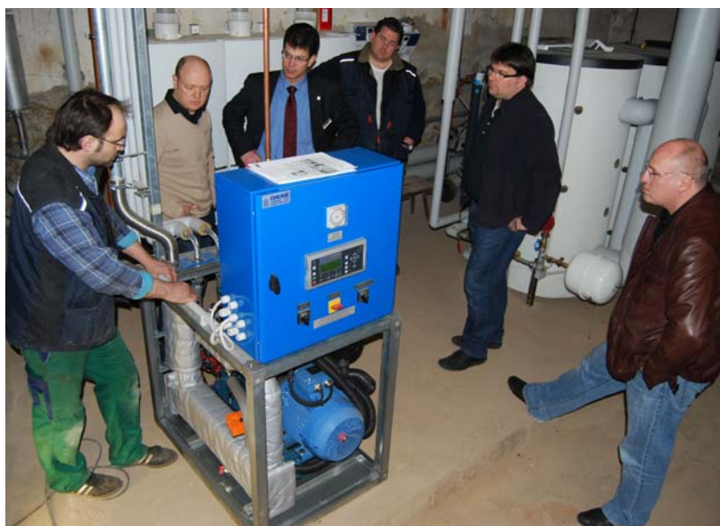
Bürgermeister Alexander Büttner bei der Inbetriebnahme des BHKWs im Keller des Rathauses. v.l.n.r.: Techniker der Fa. Giese, Lothar Römer (Mitarbeiter der Zentralen Immobilienverwaltung), Bürgermeister Alexander Büttner, Dirk Isenberg (Hausmeister), Robert Förster (Installateur), Alexander Müller (Ingenieurbüro)
