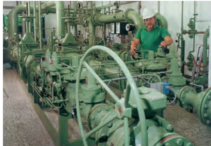
Eine von sieben Erdgasübernahmestationen der BELKAW.
