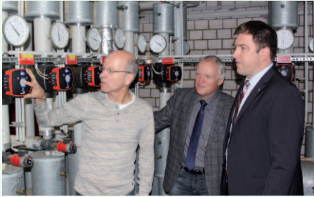
Gebäudemanager Matthias Weyer erläutert innogy Kommunalbetreuer Walfried Heinen und allgemeiner Vertreter Stefan Grießhaber (r.) die hochmodernen Umwälzpumpen der Heizungssteuerung
