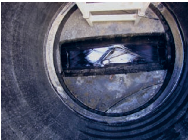
Kunststoffschacht nach mehrjährigem Betrieb
