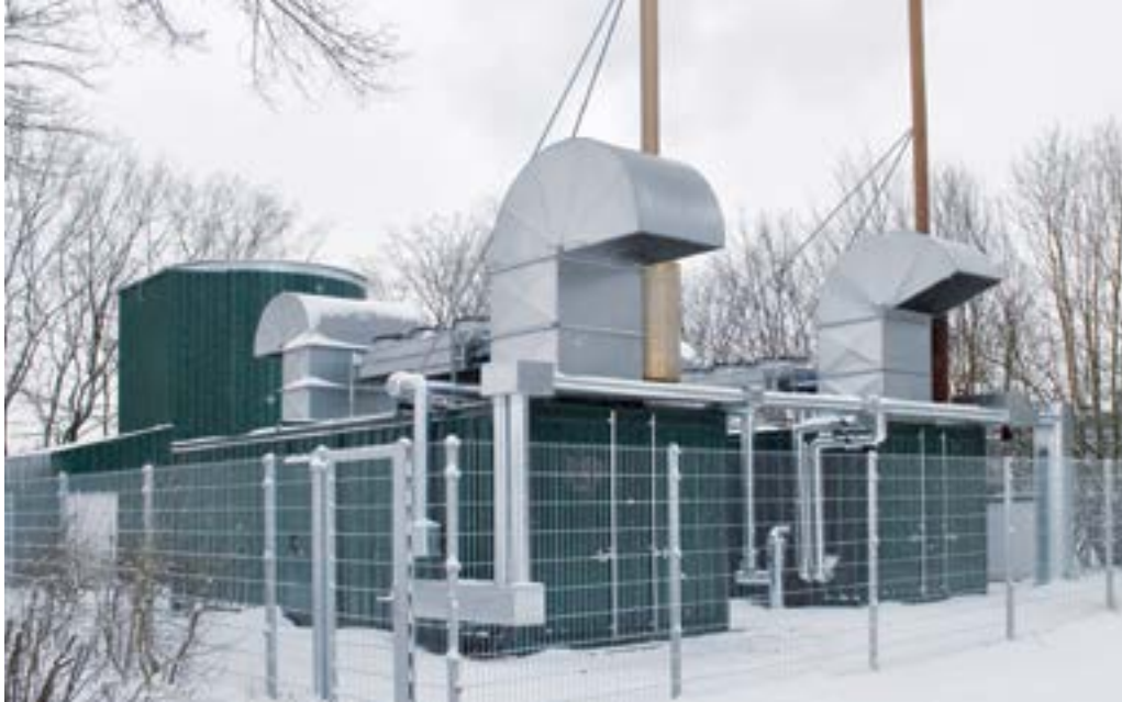
Biogas-Blockheizkraftwerk speist Nahwärmenetz
