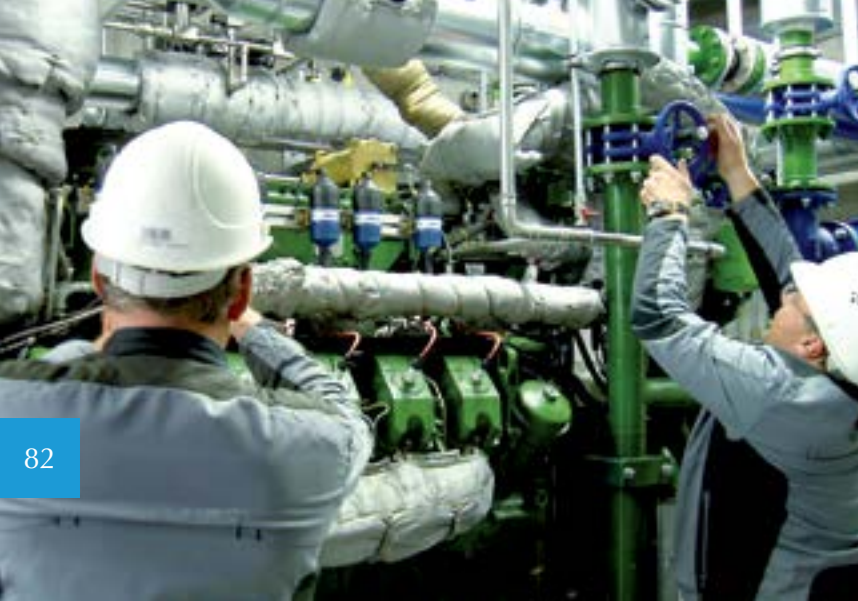
Einstellung des Blockheizkraftwerks
