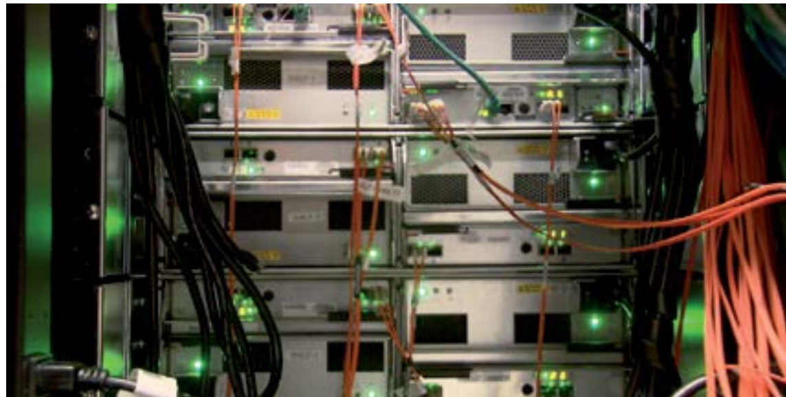
Rückansicht des Server-Bladesystems
