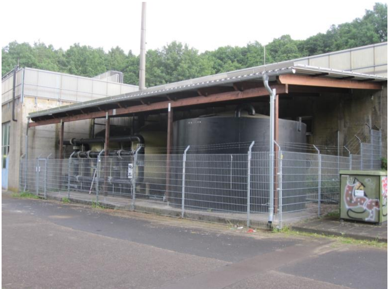
Freibad Engelskirchen, Filtertechnik mit Solardach
