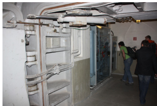
Abb. 2: Schutztüre im Bunker
