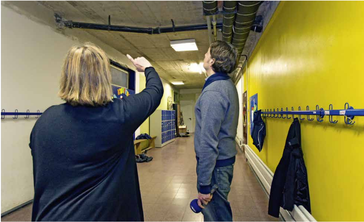
Eine Schule in Köln: Klassen in Kellerräumen, Decken ohne Verkleidung. Seit Jahrzehnten wird auch hier Flickschusterei betrieben.
