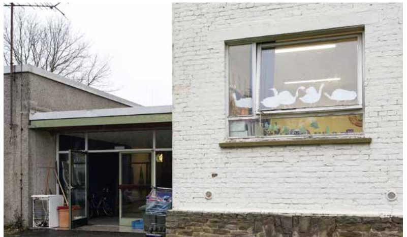
Ein Anstrich kann diese Fensterrahmen wohl nicht mehr retten, und der Eingang wirkt alles andere als einladend.
