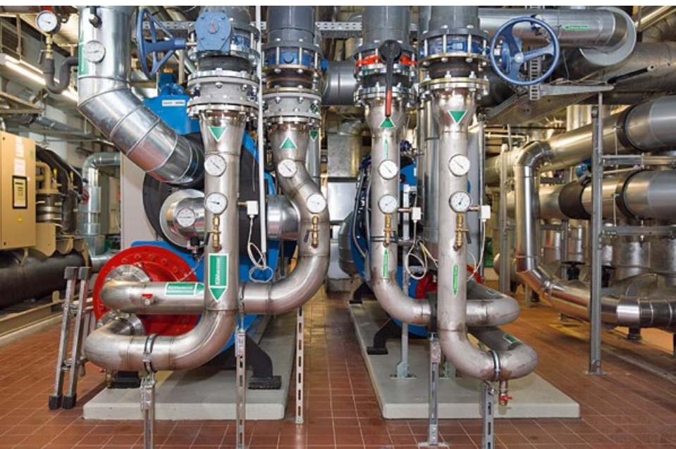
Energieeffiziente Kältemaschinen am Standort Frankfurt. Sie wurden im Rahmen des Energiespar-Contractings eingebaut.
