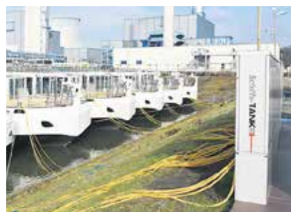
Strom statt Diesel: Im Niehler Hafen werden Hotelschiffe im Winterlager umweltfreundlich mit Energie versorgt.
