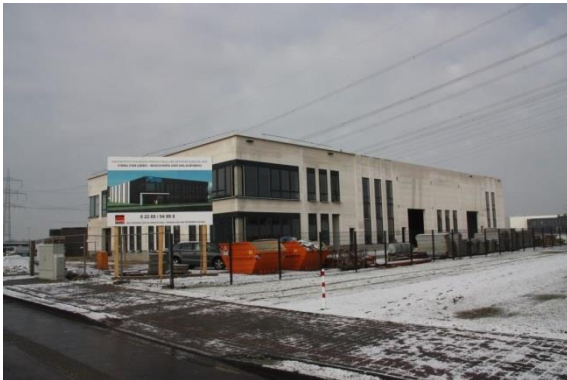
Dosieranlagenhersteller FDM GmbH (Airport Gewerbepark Junkersring)
