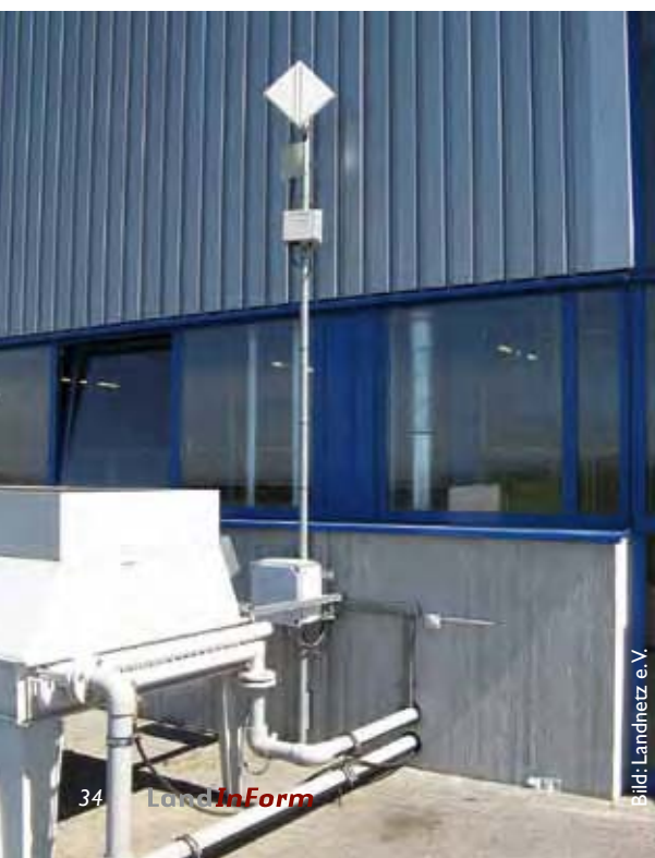
Richtfunk-Kopfstation an der Fabrikhalle der Firma Borbet in Bad Langensalza.
