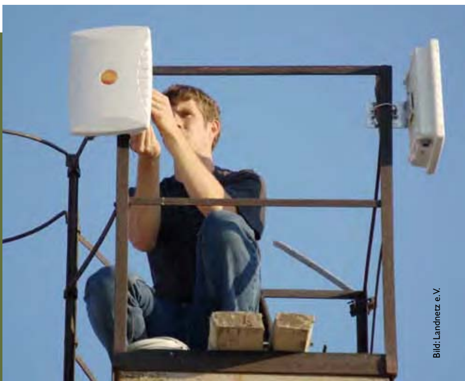
Antennenmontage am Hauptverteiler in Zimmern.
