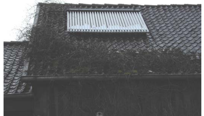
Solkollektoren auf dem Scheunendach, Steeger
