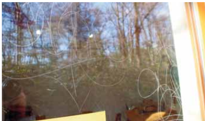
Beschädigte Fensterscheibe (Grundschule Niederzier)
