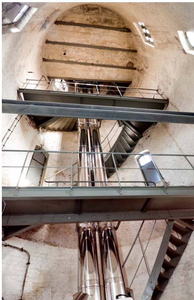
Die Heizkessel und Rohrleitungen wurden mit einer Spezialkonstruktion in die schmale Architektur des denkmalgeschützten Gebäudes eingepasst.
