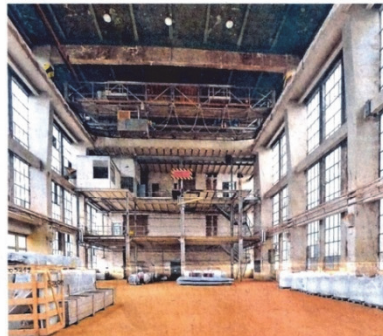
Ein imposantes Gebäude: Die 83 Meter lange und 20 Meter hohe Halle des Nassdienstes der beiden Brikettfabriken steht heute größtenteils leer.
