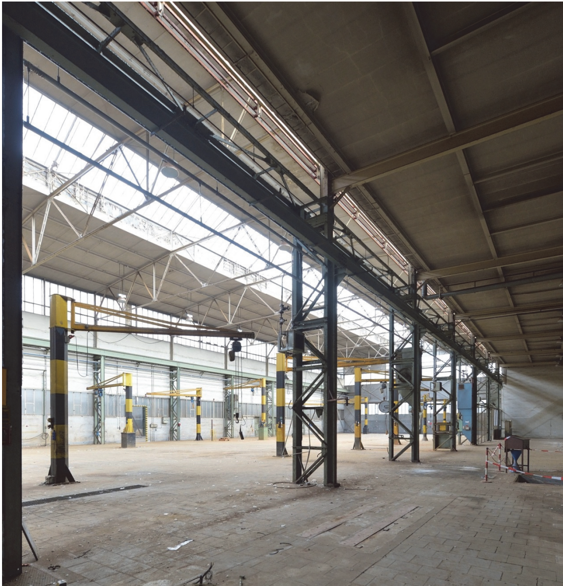
Bild 15: Krananlagen in der Hauptwerkstatt
