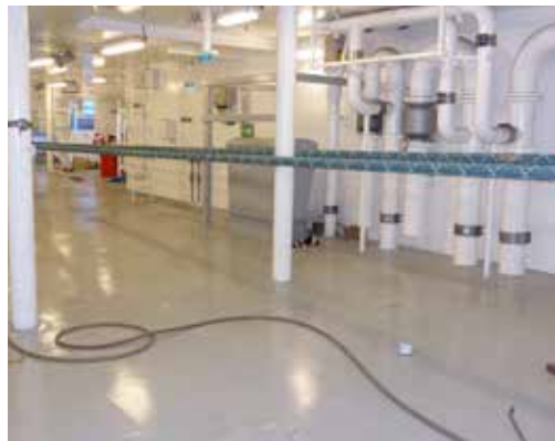
Abbildung 4: Installation der drahtlosen Sensorknoten auf dem Windendeck des Demonstrators. Die Positionen zweier Sensorknoten sind rot markiert
