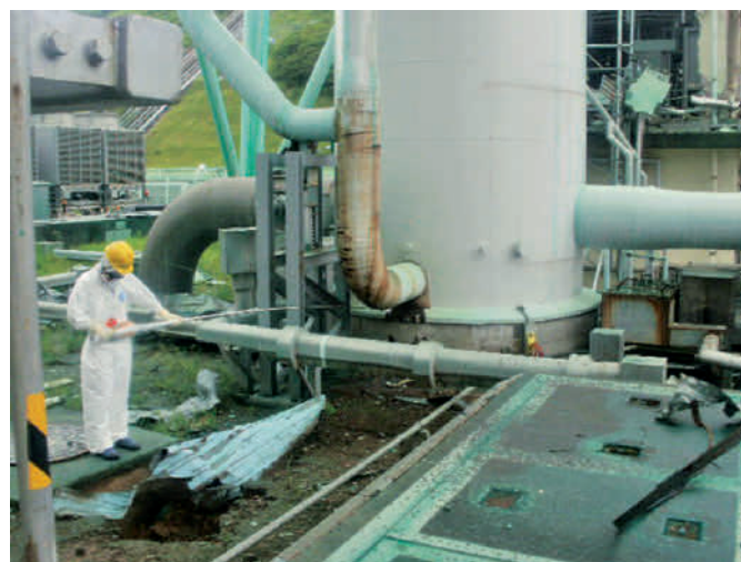
Abb. 5.6: Messung der Ortsdosisleistung mit einem Teleskopdetektor am Abluftkamin der Blöcke 1 und 2 (Quelle: TEPCO).
