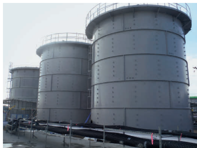
Abb. 6.12: Verschraubte Tanks mit 1.000 m 3 Volumen zur Lagerung von kontaminiertem Wasser (Quelle: TEPCO).
