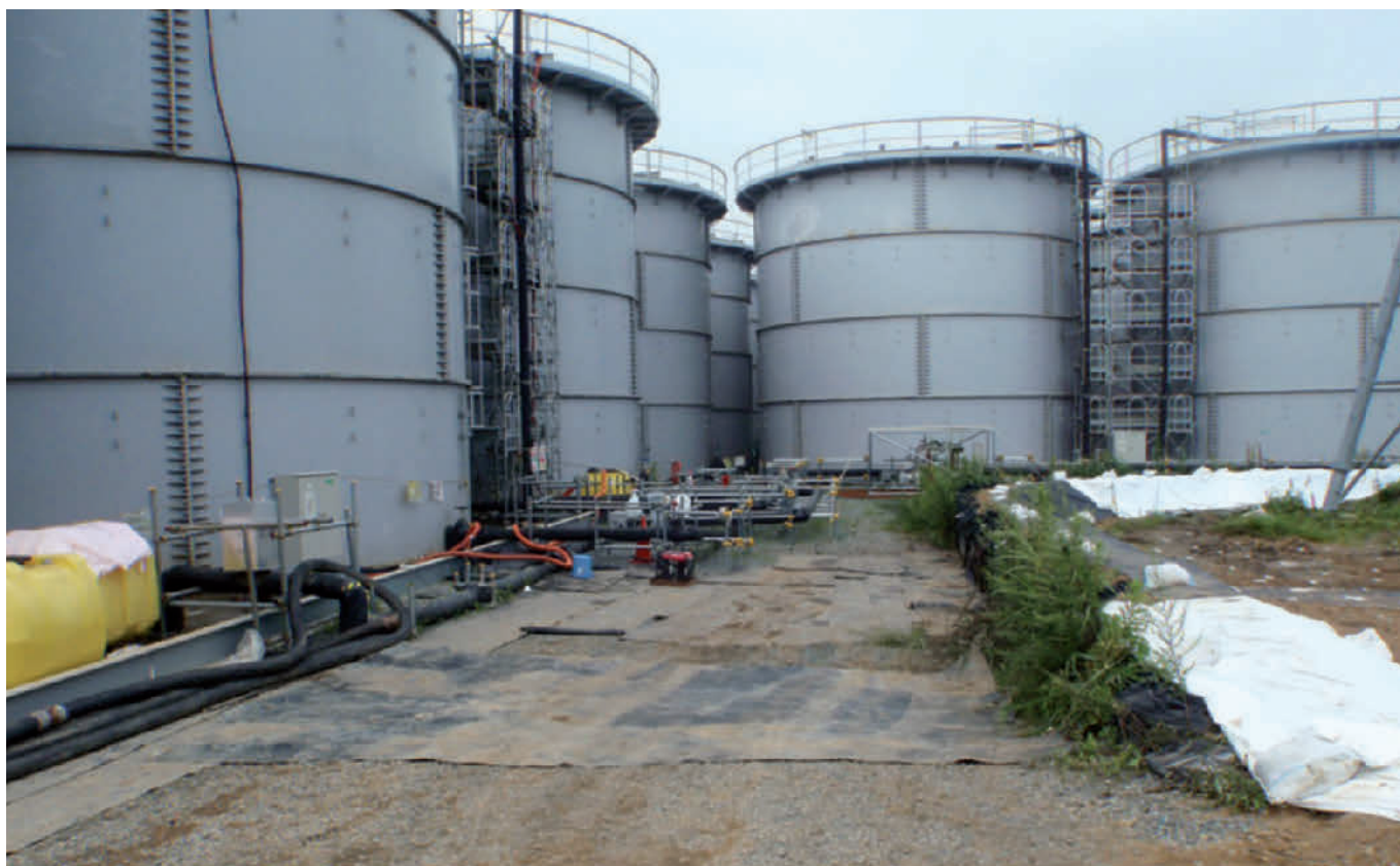
Abb. 3.35: Tanks des Aufstellbereichs H4, in dem sich die mit INES 3 eingestufte Leckage ereignete. Rechts im Bild ist ein aus Sandsäcken errichteter Wall zu erkennen, mit dem im Fall weiterer Leckagen eine weitere Verbreitung des kontaminierten Wassers verhindert werden soll (Quelle: TEPCO).
