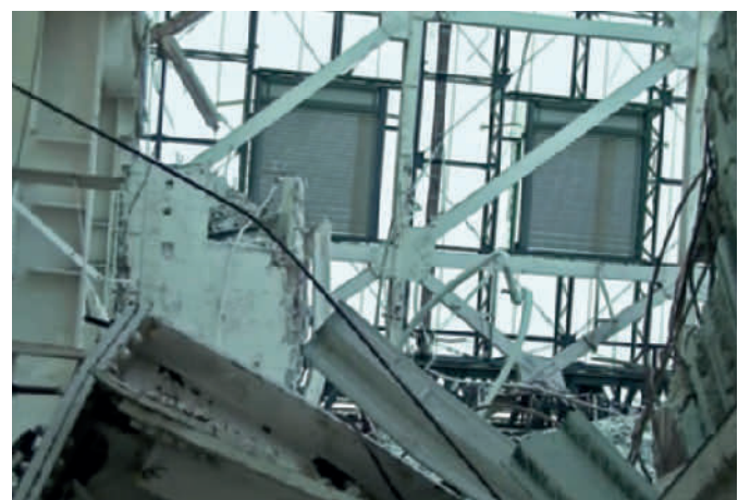
Abb. 6.28: Bildaufnahmen aus dem Einsatz eines Erkundungsballons im Oktober 2012: Blick durch den Bedienflur von Block 1 (Quelle: TEPCO).
