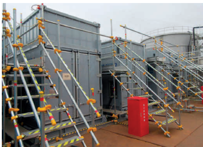
Abb. 6.7: Mobile Strontium-Reinigungsanlagen neben Tanks zur Zwischenlagerung kontaminierter Wässer (Quelle: TEPCO).
