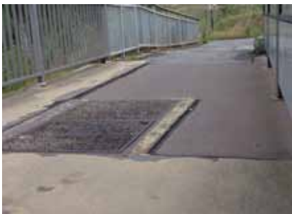
Auf der Nordseite der Brücke am Übergang zur Rampe des Rad- und Fußwegs auf Leverkusener Seite sorgen die Kanten der Kanaldeckel vor allem bei Gegenverkehr und im Dunkeln immer wieder für brenzlige Situationen.
