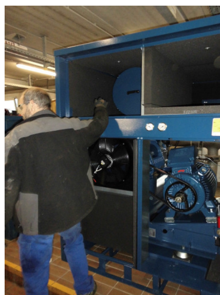
Bild: Aufbau und Inbetriebnahme durch Abwasserbetrieb Erkelenz
