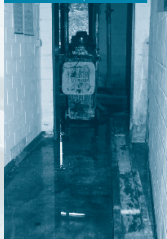
Nasser Kellerraum durch eingetretenes Grundwasser
