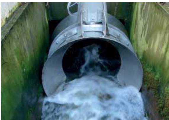
Die Abwasserturbine erzeugt Strom ohne CO 2 -Ausstoß.
