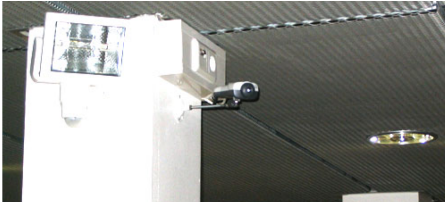
Kamera im Kassenbereich des Cafeleven in der Nassestraße.
