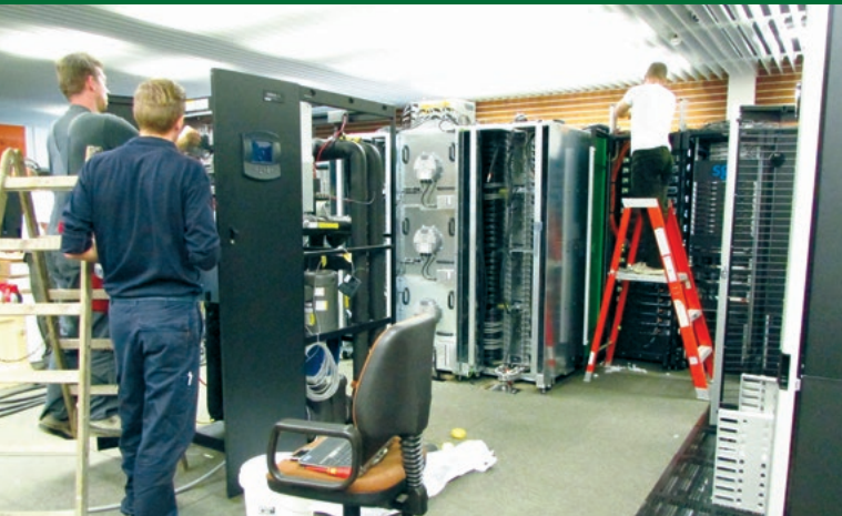
Der im Oktober 2013 errichtete Hochleistungsrechner ist zwar kleiner als sein Vorgänger, dafür aber deutlich schneller: Bis zu 262.000.000.000.000 Rechenoperationen pro Sekunde bewältigt das neue C 2 A 2 S 2 E-Cluster
