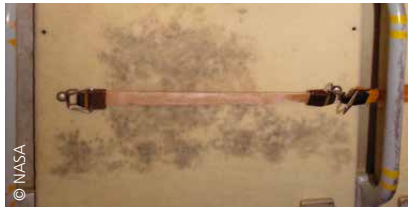
Die mikrobielle Verunreinigung durch Pilze, Keime und Sporen sind für die Gesundheit der Astronauten und für die Hardware eine große Gefahr.
