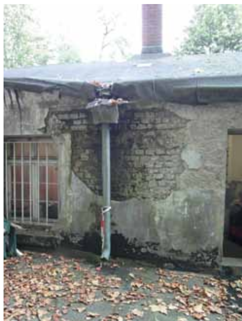
Feuchtigkeitsschäden gefährden die Bausubstanz.
