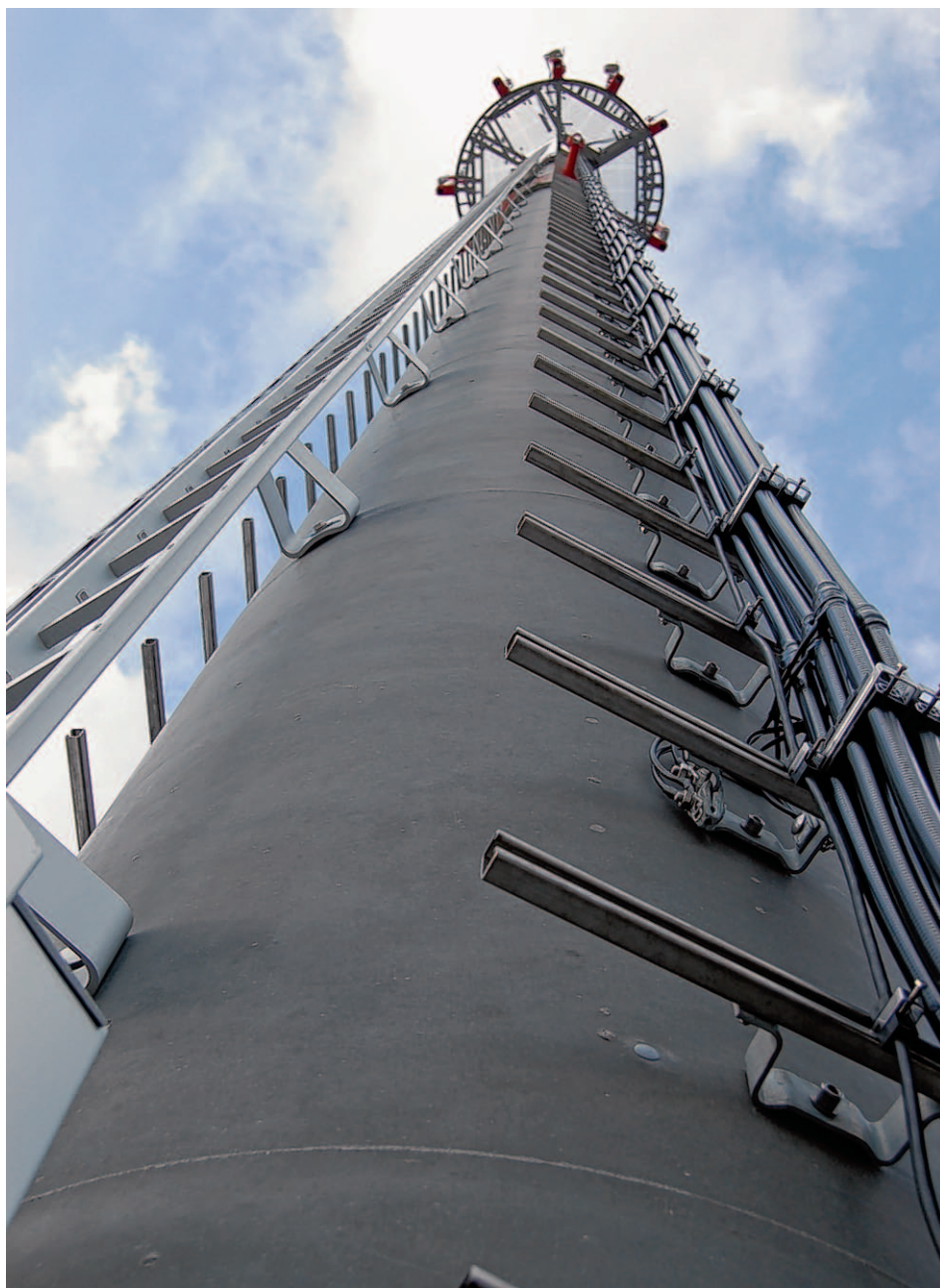
Die rot-weiße Signalmarkierung am oberen Ende des Mastes ist gut zu erkennen.
