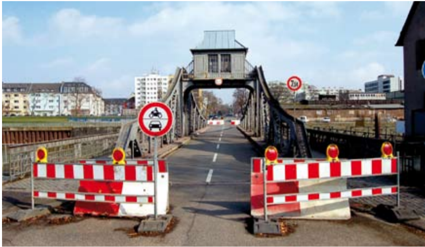
102 Jahre und denkmalgeschützt: Die gesperrte Drehbrücke wird bald repariert | Bilder: Mainzer
