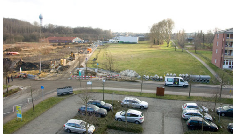
Abb. 20: Beginn der Bautätigkeiten für das neue Einkaufszentrum am Wasserturm (Verlegung der Versorgungsleitungen). Foto: Stadt
