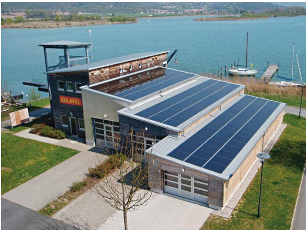
Photovoltaikanlage auf dem Dach des DLRG-Hauses am Werratalsee im Rahmen des BürgerSolarProjektes
