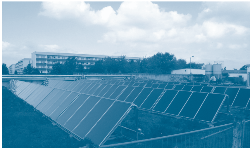
Abbildung 20: Thermische Solaranlage der Stadtwerke Wanzleben (Foto: BTU Cottbus)
