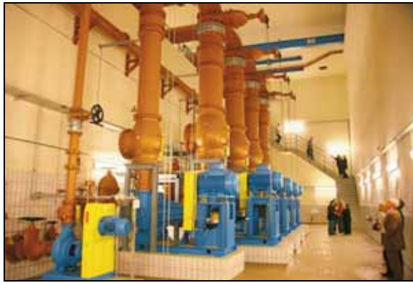
Das neue Pumpwerk an der Schönhauser Straße fand bei den Eröffnungsgästen viel Beachtung.
