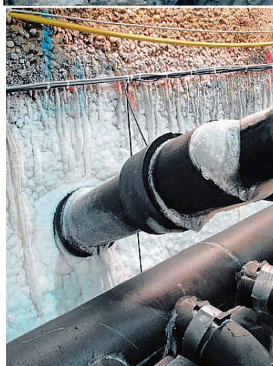
Eine vereiste Leitung unterhalb der Severinstraße.
